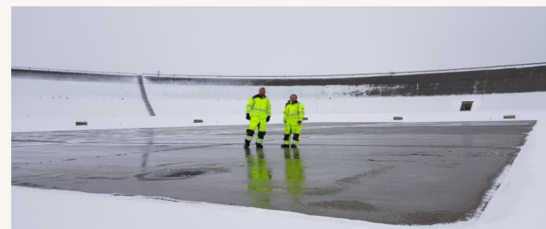
Vi utviklet og følger opp bergvarmeanlegget for bakkevarme til avising av betongen i motortestområdet Oslo Lufthavn Gardermoen
